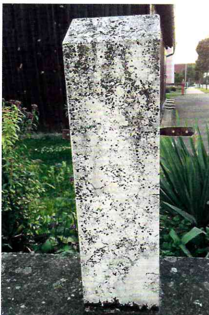
Pfeiler aus AUERKALKSTEIN mit Algen und Flechten vor der Reinigung
